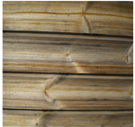
Fasádní obklad v průběhu procesu stárnutí (přirozené jsou nestejněměrné barevné změny)
